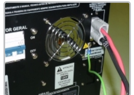
Conectar cabo de expansão e fio terra no gabinete nobreak
